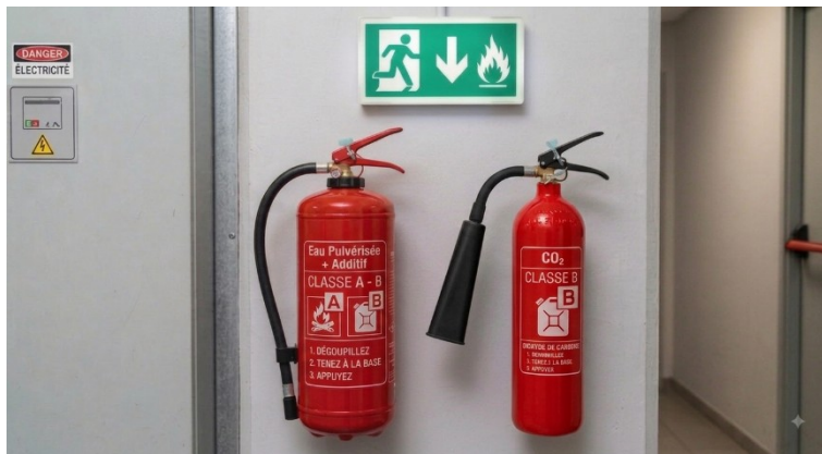
Repérage des différents types d'extincteurs et de leur signalisation
